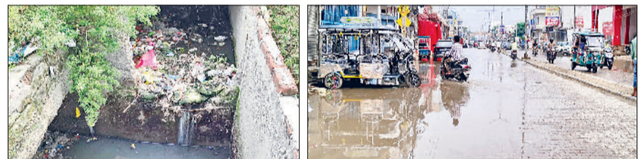
गजौल। नगरपालिका रोड पर सफाई के बावजूद गंदगी से अटा पड़ा नाला, सफाई में खानापूरति होने से बरसात के बाद ओवरफ्लो होकर सड़क पर जमा नालों का पानी।
